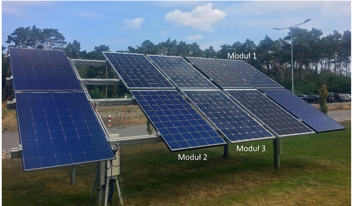
Rys.2. Instalacja badawcza przy ul. Paciorkiewicza w Bydgoszczy
